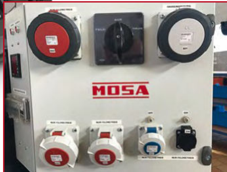
Steckdosenfeld mit Umschalter
